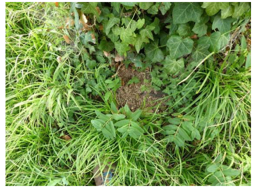
Abbildung 6: Faulhöhle an Stammfuß eines Silber-Ahorn im Untersuchungsgebiet (30.08.2023)
